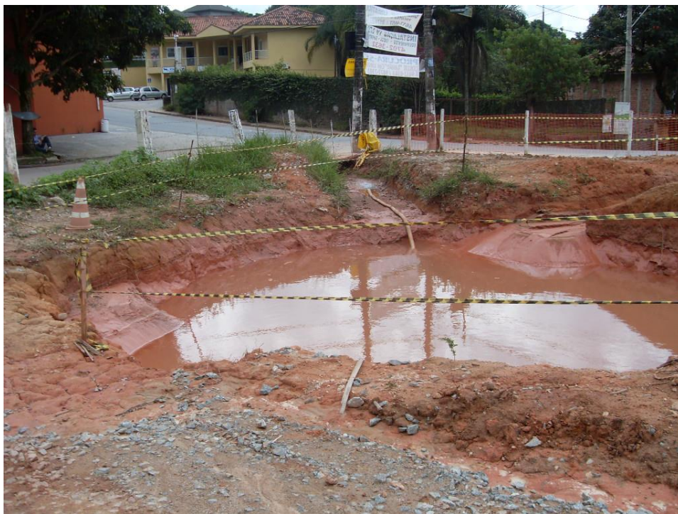
Figura 5.2 – Bacia de contenção de sólidos
